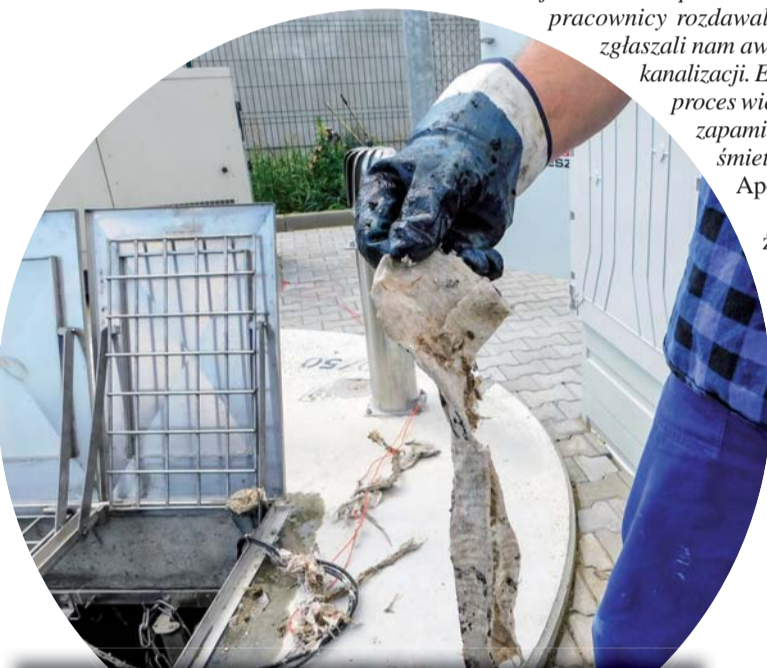
▲ Zmurą w przepompowniach są chusteczki nawilżane. Oblepiają urządzenia, co prowadzi do ich uszkodzenia.
