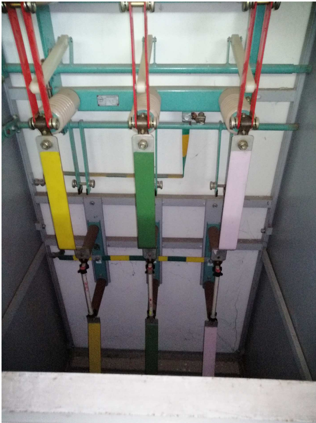
20.8 Załącznik nr 8 – zdjęcie istniejącego pola nr 18 w rozdzielnicy SN – pole transformatorowe
